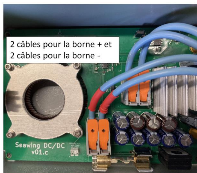
Figure 15 : Connexion des câbles batterie dans le boîtier de régulation
